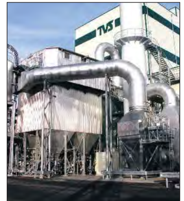
Foto: Rauchgasreinigung der TVS
